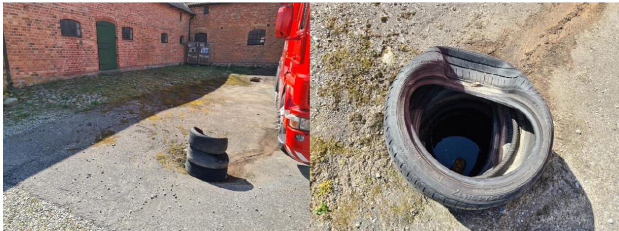
Figur 10 Befintlig dagvattenbrunn, full vid platsbesök men efter fastighetsägaren rensat den låg vattennivån på ca 1,5 m djup
