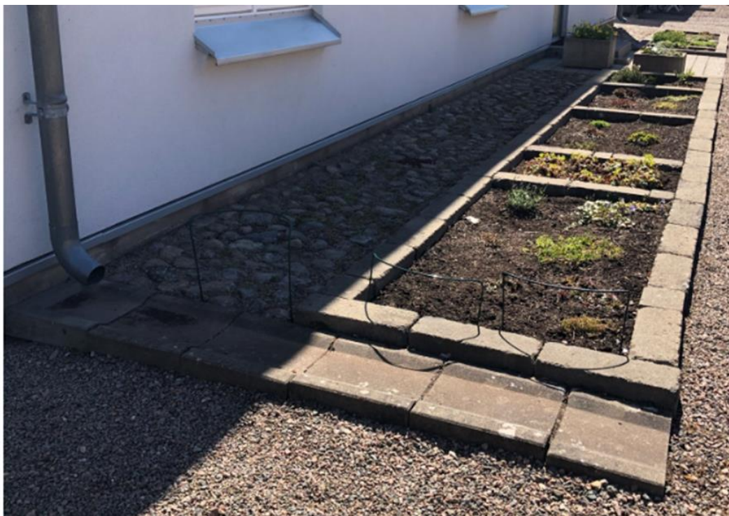
Figur 20. Exempel på ytlig avledning från stuprör från Mariastaden i Helsingborg. Foto: Tyréns AB.
