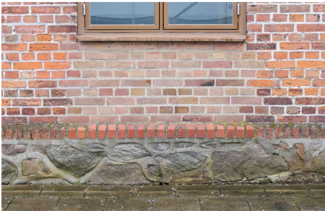
Lagning eller en igensatt öppning på norra fasaden.
