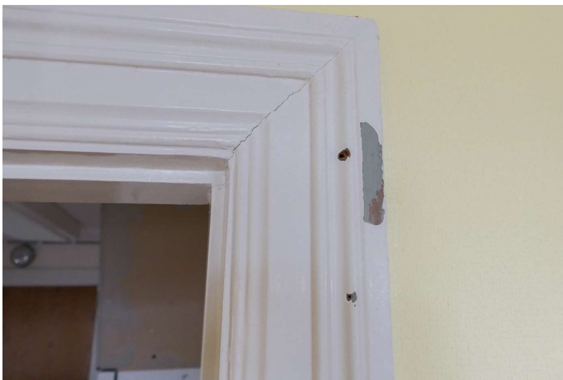
De äldre dörrfodren har brun och blågrå kulörer under flagande färgskikt.
