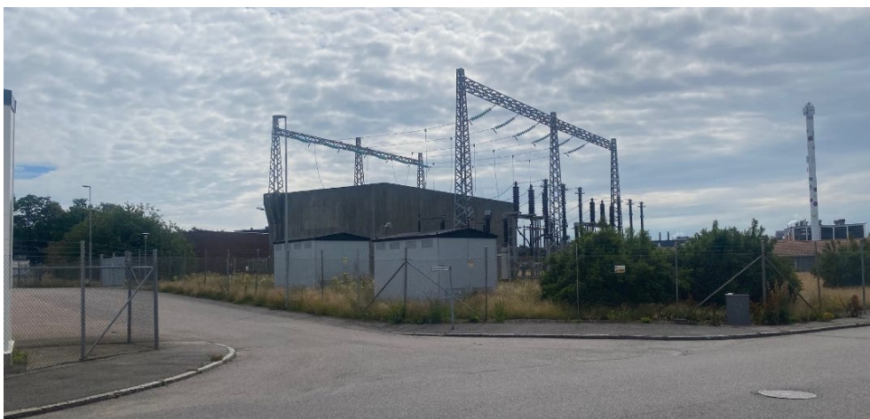
Figur 5. Ställverket som angränsar till fastigheten Rovän 8.
